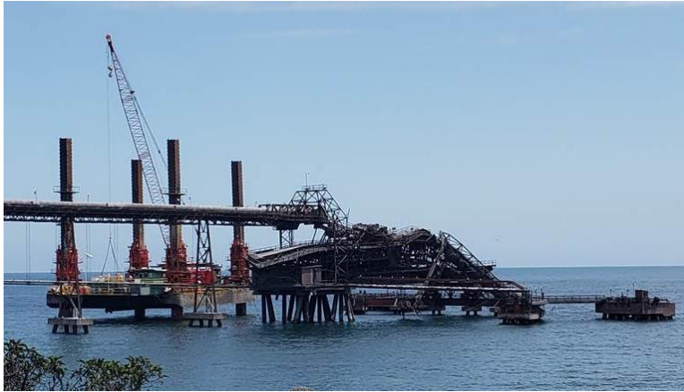
Estructura del puerto después del accidente en noviembre de 2018
