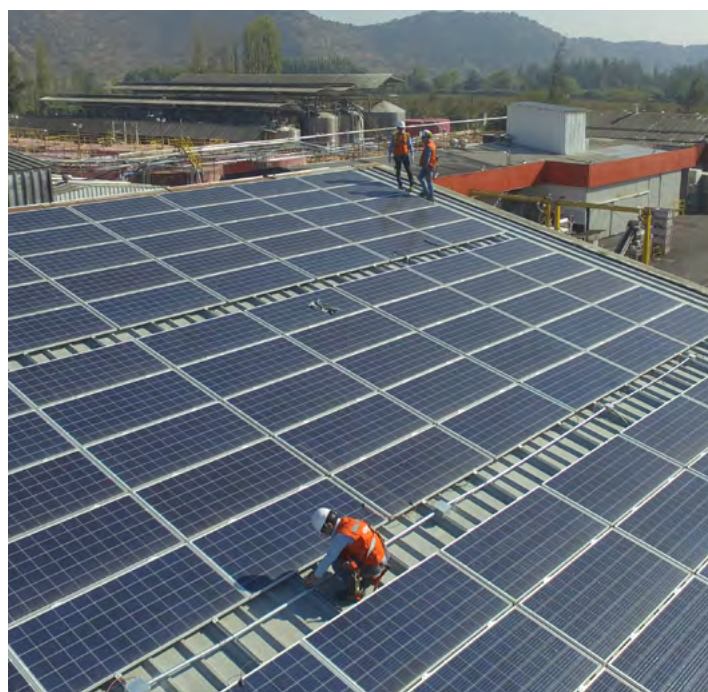
Cintac ha instalado más de 100.000 m 2 de plantas sobre cubierta (rooftop), tal como en Viña Lourdes.
